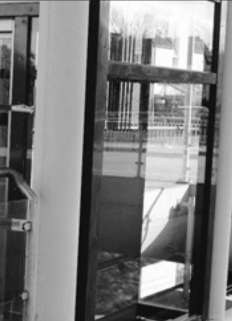
Wer gehofft hatte, den Fahrstuhl an der S-Bahn-Station wieder häufiger nutzen zu können, wurde eines Besseren belehrt: Wieder einmal ist er außer Betrieb. Foto: Stefanie Käfferlein
